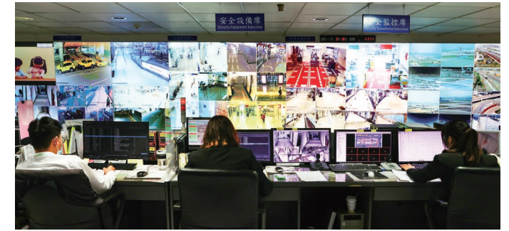
▲OCC透過機場園區內3000多支攝影機，維護場內安全。
