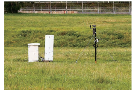
▲裝設在桃園機場05R跑道落地段旁的跑道視程儀。
